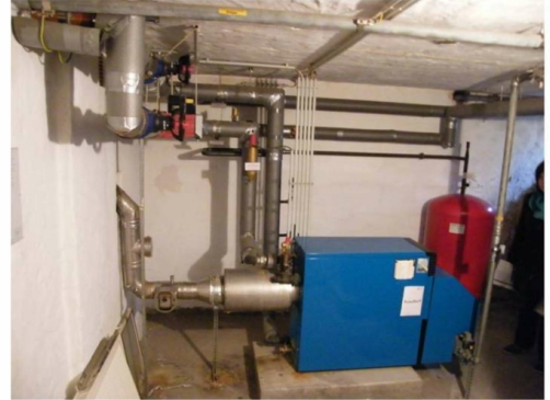
Neue Gasheizungen Bahnhofstr., Poststrasse, neue Leitungen zu jeder Wohnung Abrechnung über ISTA - Zähler
